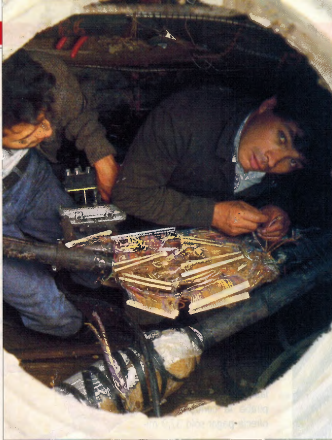
▲ Durante varios años hubo obras en ciudades pequeñas y grandes para instalar las líneas de los convenios de riesgo compartido de Telecom
