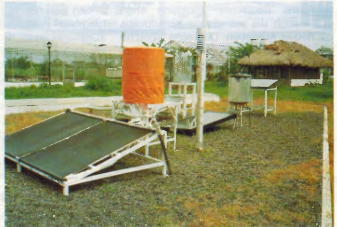
Thermische Solarkollektoren im PESENCA-Testzentrum Turipaná im Testbetrieb.
