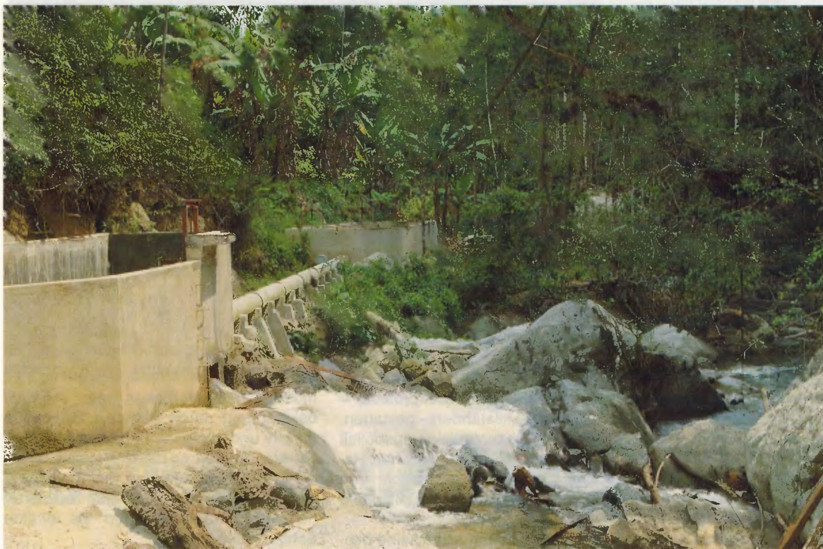
Wasserschloß und Entsandungsanlage der Kleinwasserkraftanlage Palmor, Sierra Nevada de Santa Marta.
